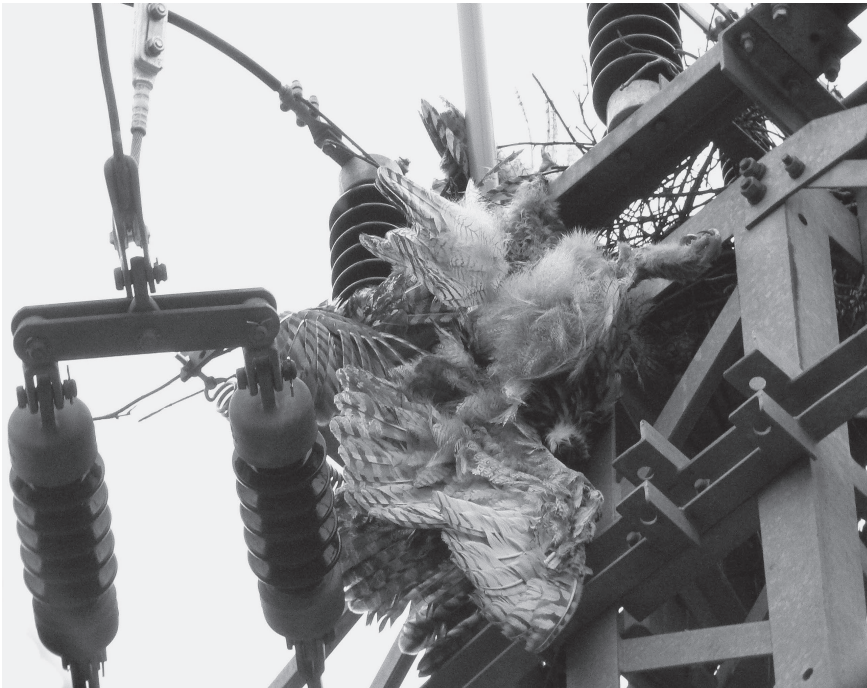
Abb. 3: Mittelspannungsmast und durch Stromschlag getötetes Uhu-paar in Niederhausen an der Appel/Rheinland-Pfalz Juni 2012 vor Ablauf der Umrüstungsfrist. Foto: Michael Knödler
