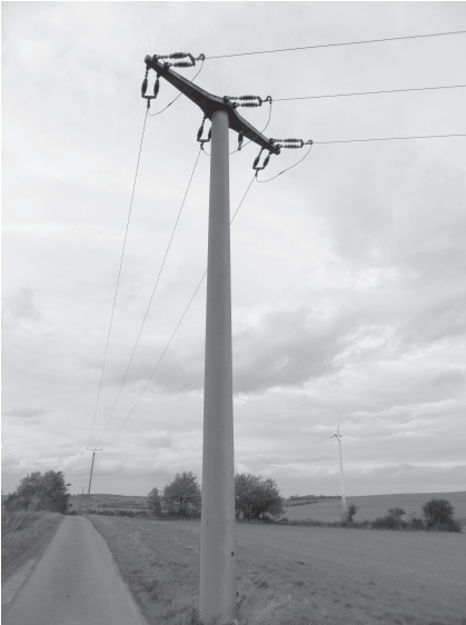
Abb. 1: Gefährlicher Mittelspannungsmast bei Mechnich-Berg (Stichprobe 4), an dem am 08.03.2013 ein durch Stromschlag getöteter Uhu aufgefunden wurde. Foto: Stefan Brücher
