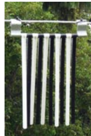
Markierung für Erdseile an Hochspannungsleitungen. Foto: Winfried Böhmer
