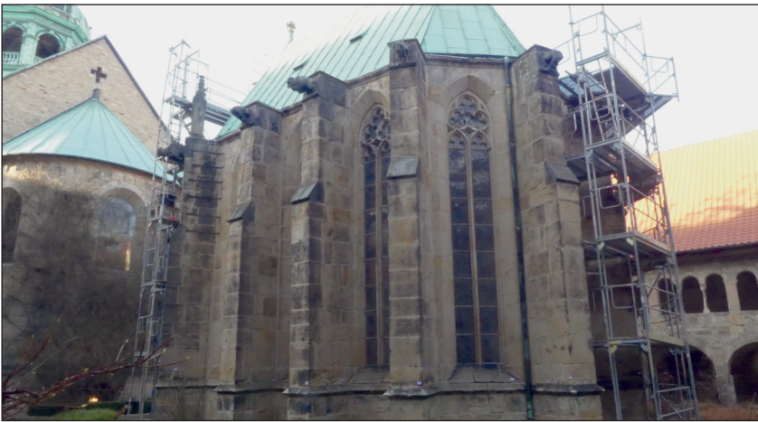
Abbildung 1: Annenkapelle im Kreuzgang des Hildesheimer Domes am 26.01.2021. Das Baugerüst (rechts im Bild) an der Apsis der Kapelle befindet sich unmittelbar gegenüber dem Uhunistplatz. Am linken Bildrand ist die Domapsis mit dem 1.000-jährigen Rosenstock zu erkennen (Foto: ANGELIKA KRUEGER)
