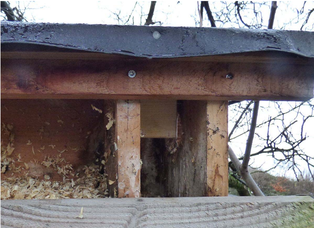
Abbildung 6: schmalerer Vorraum mit nachträglich angebrachtem 7 cm breitem Marderschutz
